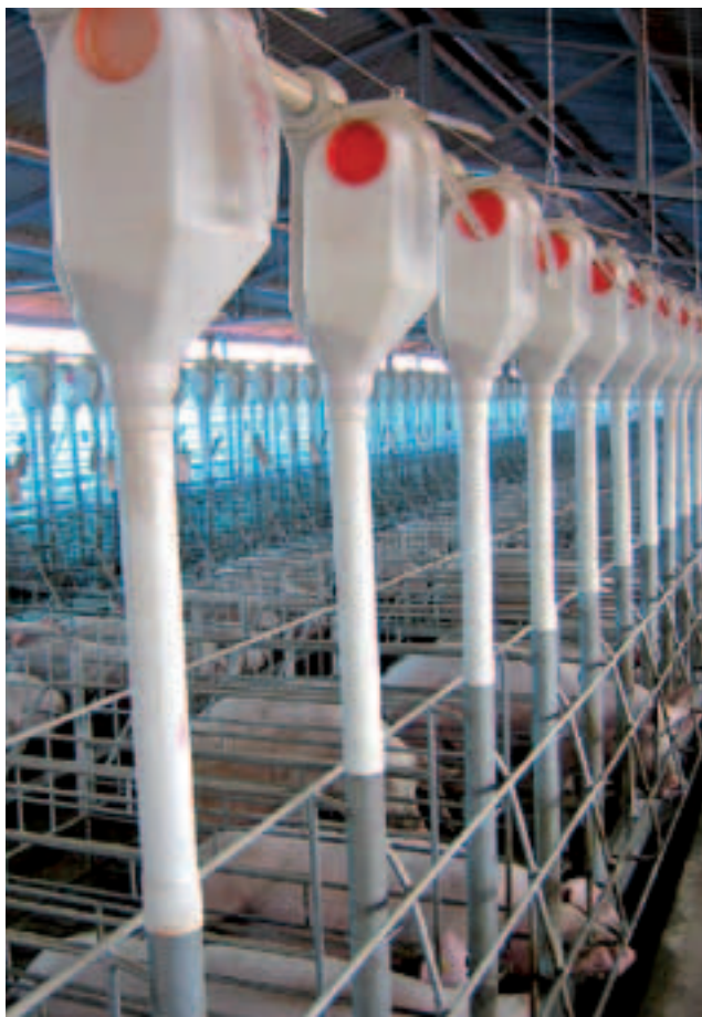
Sistema Ductofan instalado na sala de maternidade
