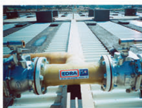
ETE de grande porte
