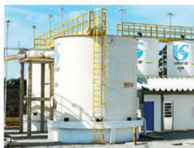
ETA de Reuso
